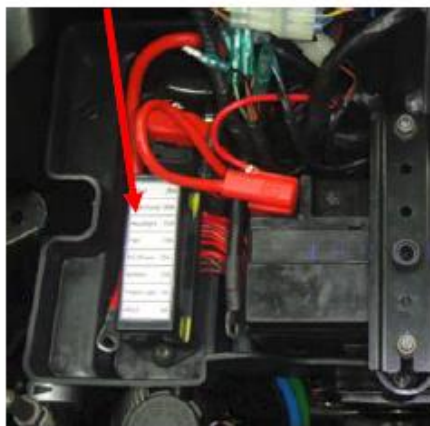
Pokrywa skrzynki bezpiecznikowej
